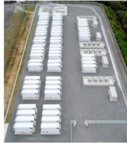
2024年12月にオリックスと関西電力が運転開始をした紀の川蓄電所＝和歌山県紀の川市、両社提供
